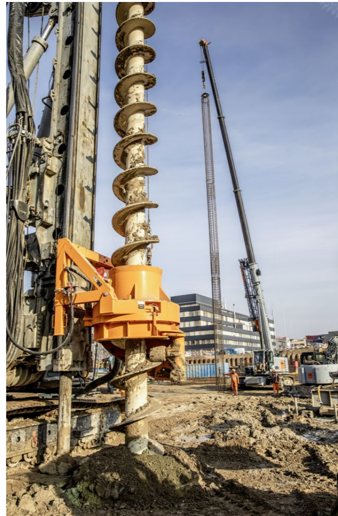
Nachdem die korrekte Ausführung der Bohrung kontrolliert wurde, kann die Bewehrung eingesetzt werden.
