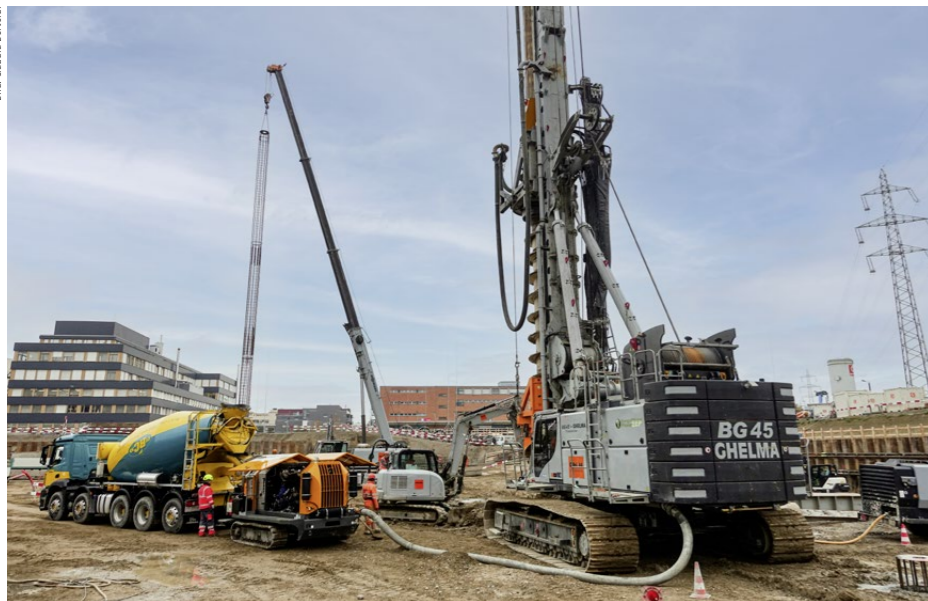
Am Grossdrehbohrgeräte Bauer BG 45 ist eine Betonpumpe (links im Bild) angeschlossen, über die kontinuierlich das Bohrloch von unten her verfüllt wird, sobald die Bohrschnecke ausfährt.
