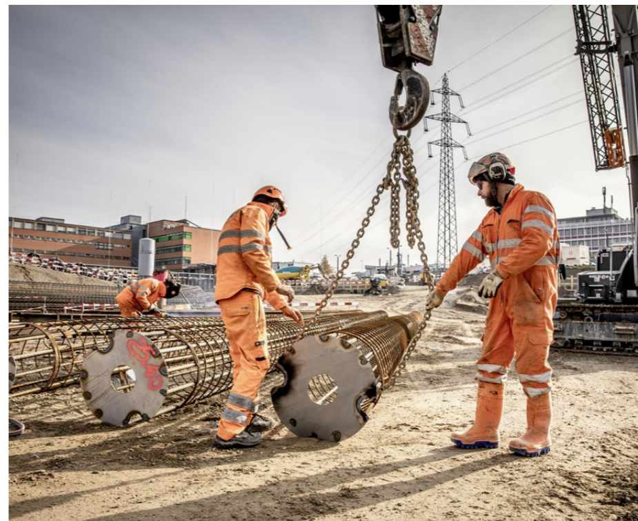
Die riesigen Armierungskörbe werden aus Einzelteilen direkt auf der Baustelle zusammengeschnitten. Sie sind bis 30 Meter lang und wiegen jeder rund drei Tonnen.
