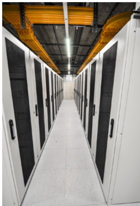
In solchen Racks werden die Server aufbewahrt.
